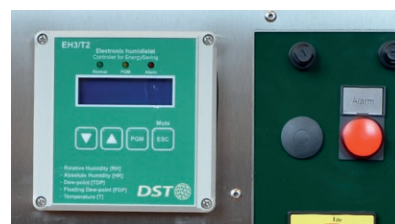
EH3 T2 monterad i avfuktare typ R-61R
