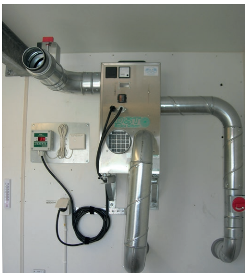
Luftavfuktare typ DR-010B installerad i tryckstegringsstation, kopplad till EH4
