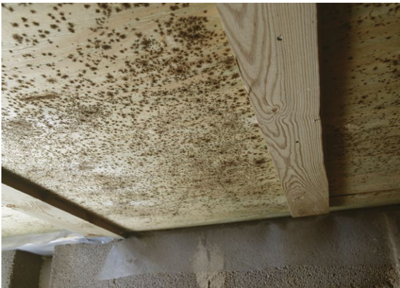
Mögeltillväxt på blindbotten i villa byggd 1991.
